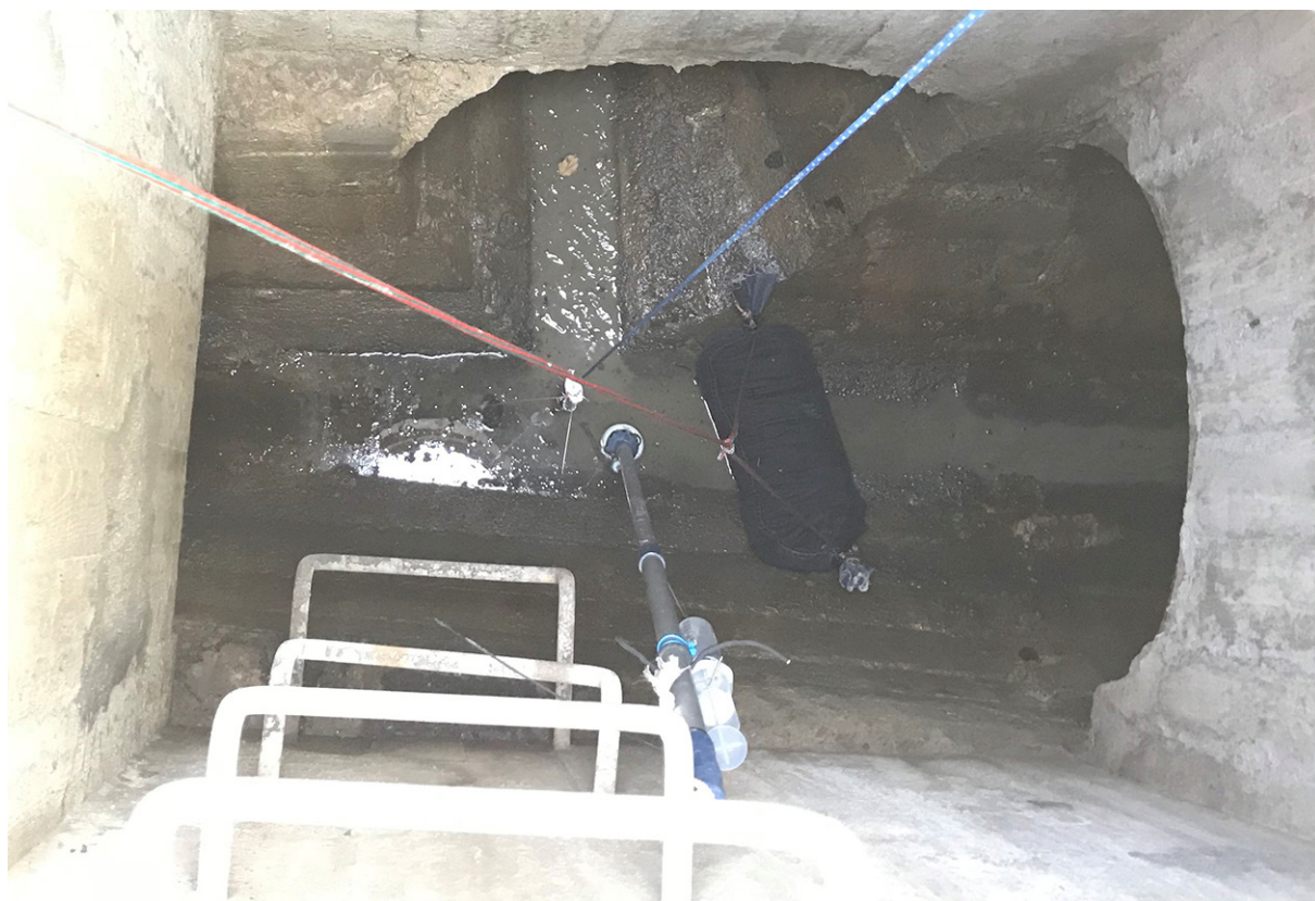
Exempel på provtagning med TIMFIE-provtagaren i en dagvattenledning. Ett dämme har placerats i avloppsrörets låga vattenflöde för att möjliggöra provtagning. TIMFIE-provtagaren sitter monterad på ett aluminiumskaft. Foto: Ove Jonsson.
