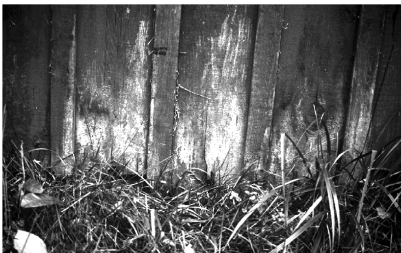
FIGUR 1. Felaktig grundmåning och för kort avstånd från panelen till marken leder till röta.
