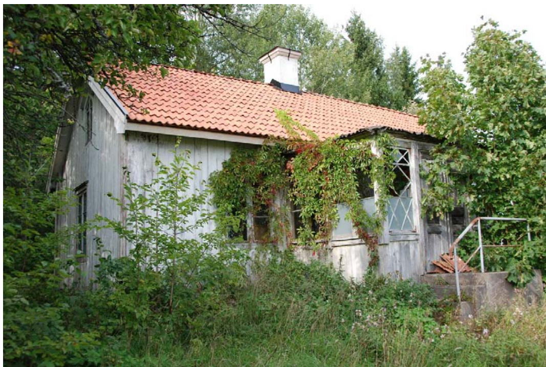
Figur 1: Bostadshuset på bilden illustrerar väl behovet av att göra separata bedömningar av de olika byggnadsdelarnas skick. KMÖ-NILS metod omfattar bedömning av skicket på tak, fasad, stomme respektive grund. Foto RAÅ.
