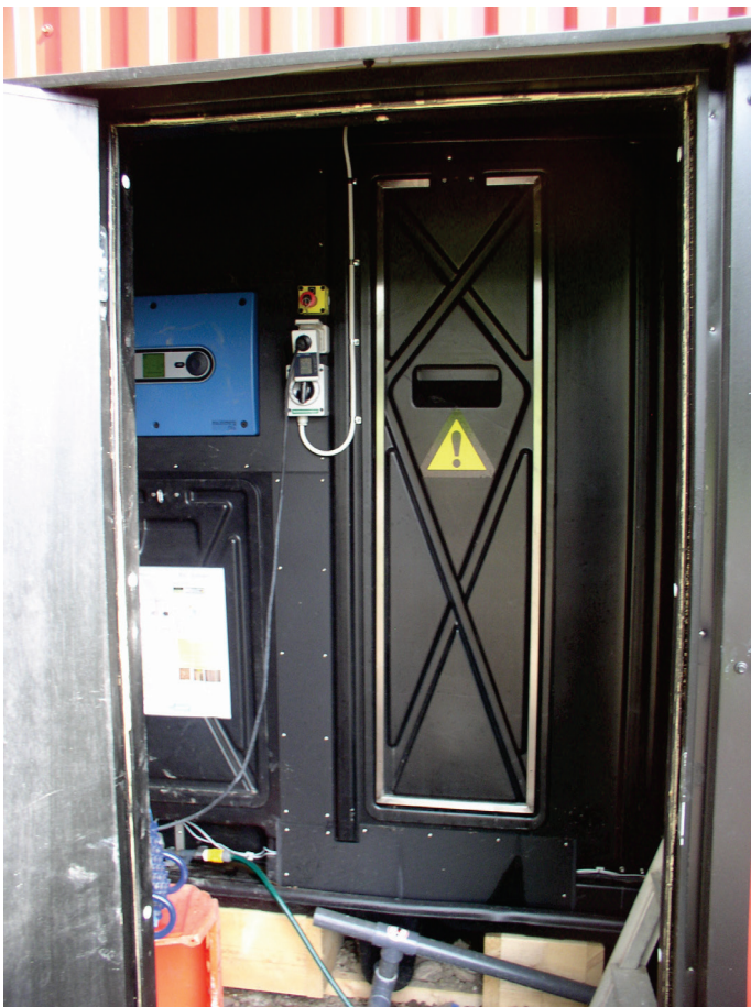
Bild 4: Skrubber med två filter.
